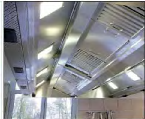
Hotte avec filtre à graisse, éclairage et gouttière de récupération des buées.
