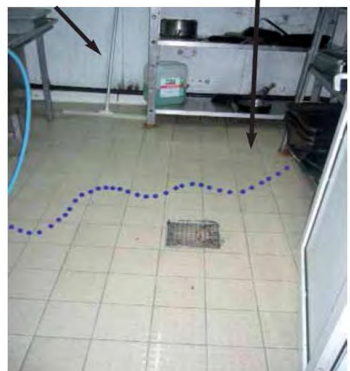
Pente vers la bonde syphoïde insuffisante, présence d'eau au sol en permanence (la présence de la raclette en témoignage), risque de chute par glissade
