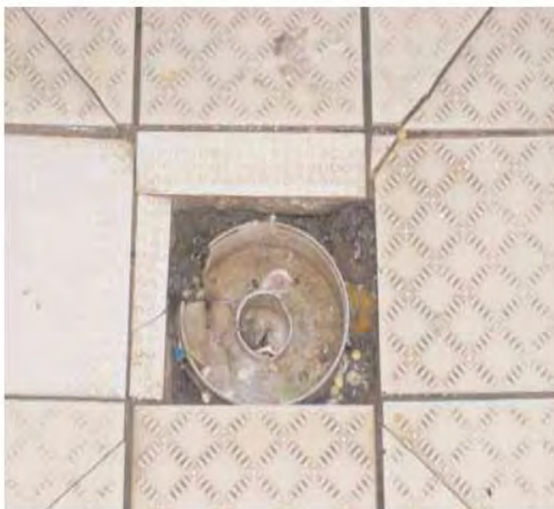
Bonde syphoïde non refermée après nettoyage. Problème de sécurité de personne (risque de chute)
