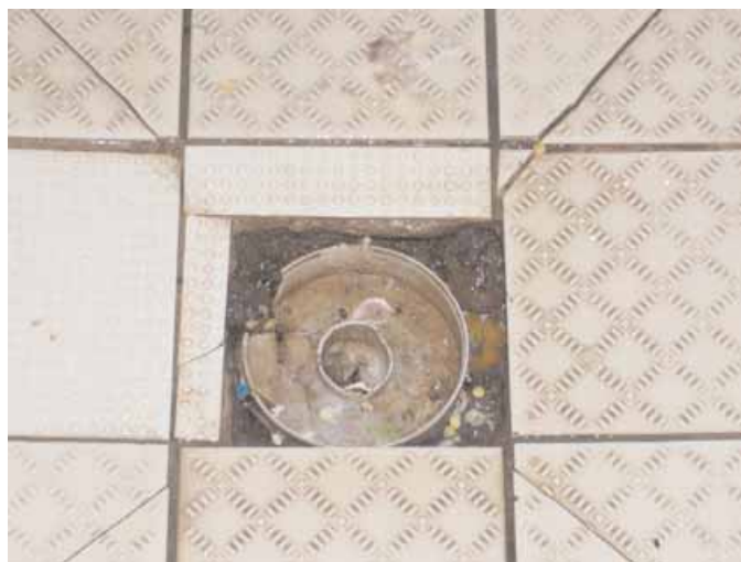
Bonde syphoïde non refermée après nettoyage. Problème de sécurité de personne (risque de chute)
