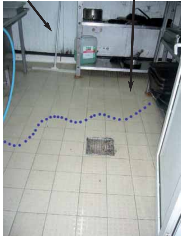
Pente vers la bonde syphoïde insuffisante, présence d'eau au sol en permanence (la présence de la raclette en témoigne), risque de chute par glissade
