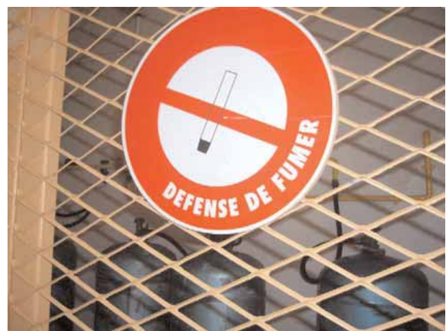
Stockage du gaz à l'extérieur éloigné des points chauds.
