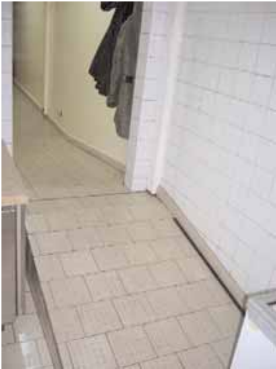
Sol anti-dérapant, mais avec une pente pouvant être à l'origine de chute
