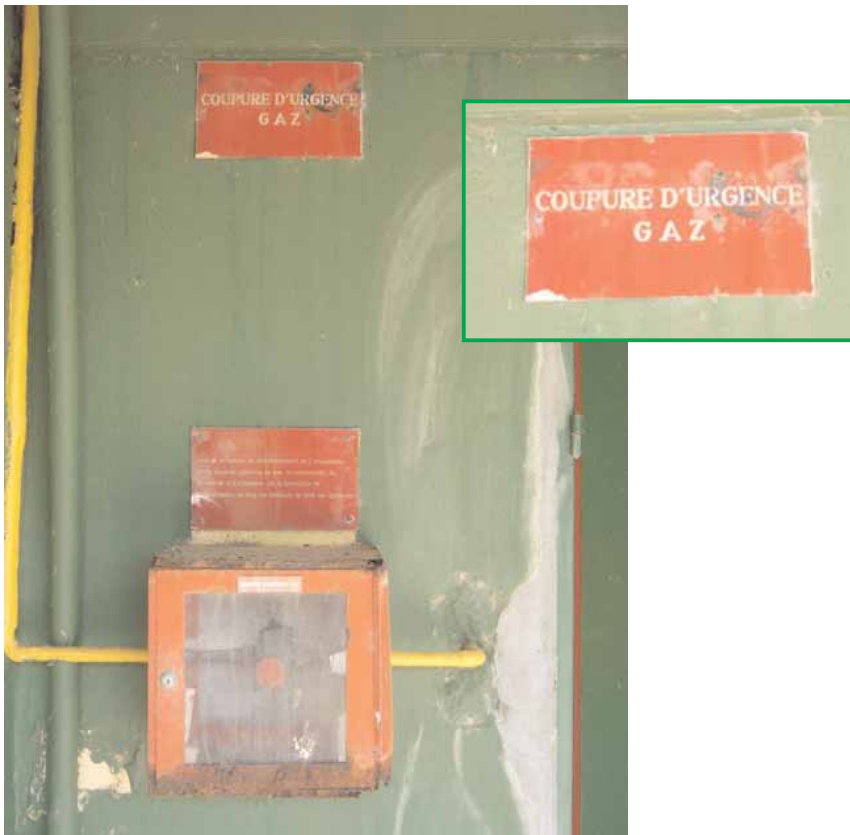
Dispositif de coupure générale du gaz
